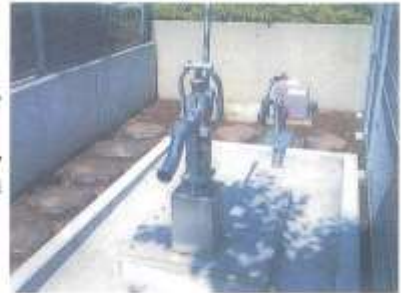
併用型井戸 (電動・手動型) Pマンション 2007/6/5撮影 (東京都世田谷区)
